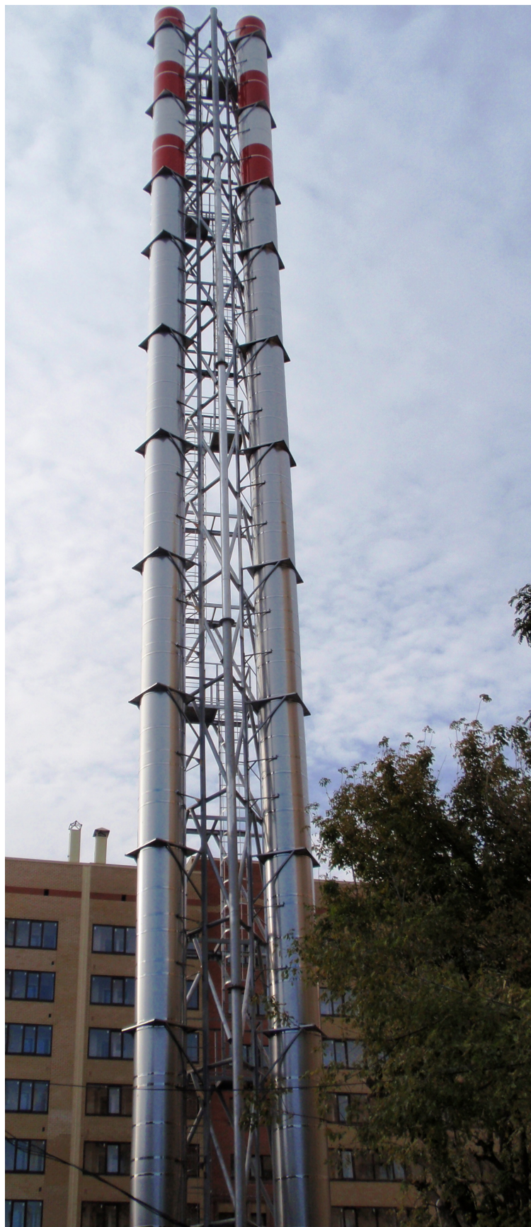
г.Ставрополь, Центральная отопительная котельная (ЦОК) ф1000х1100мм, 2шт., Н=40м
