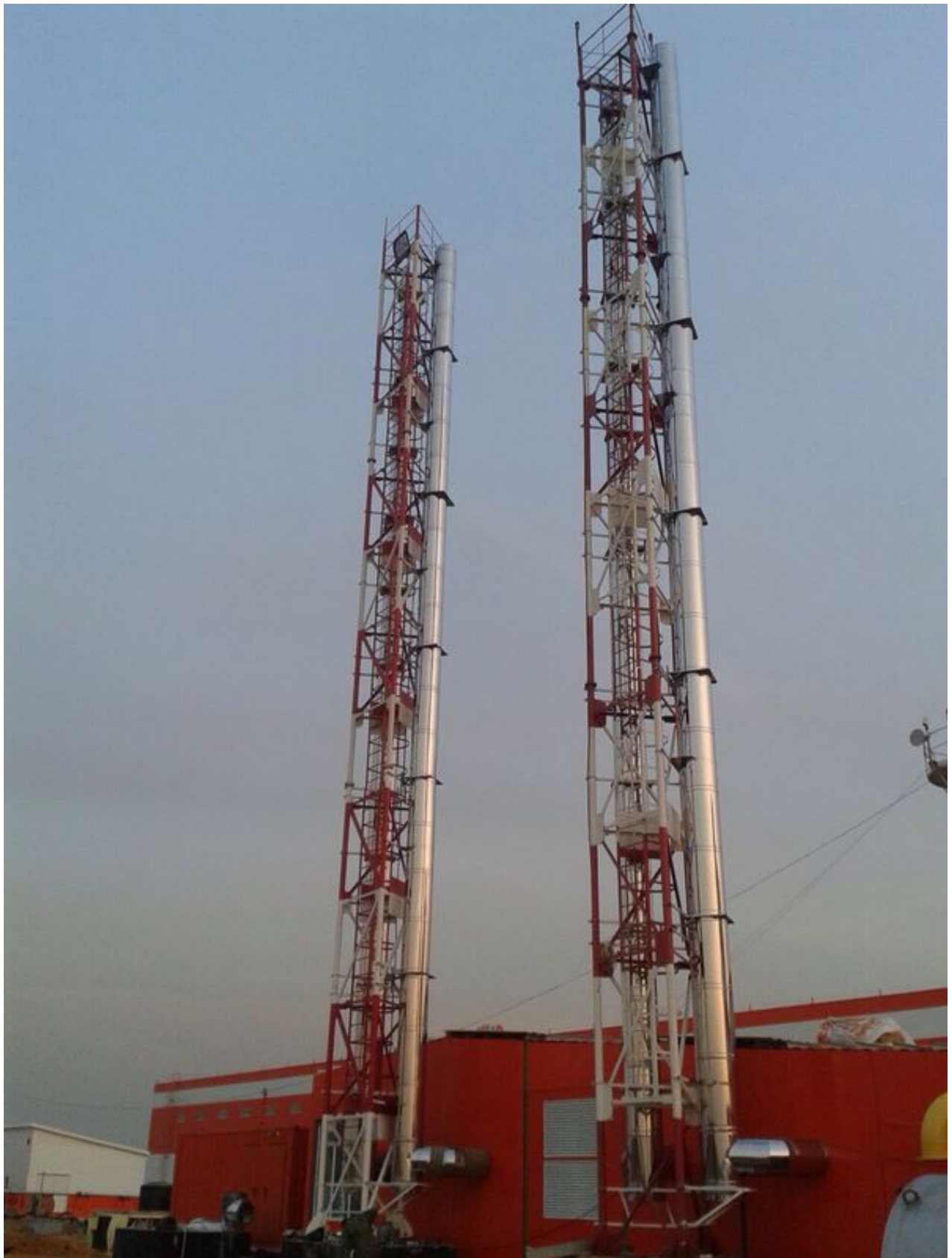
Московская область, п.Бритово, Складской комплекс Дымоходы \phi 500 \times 600 \text{ мм} , 4шт., H=24 \text{ м}
