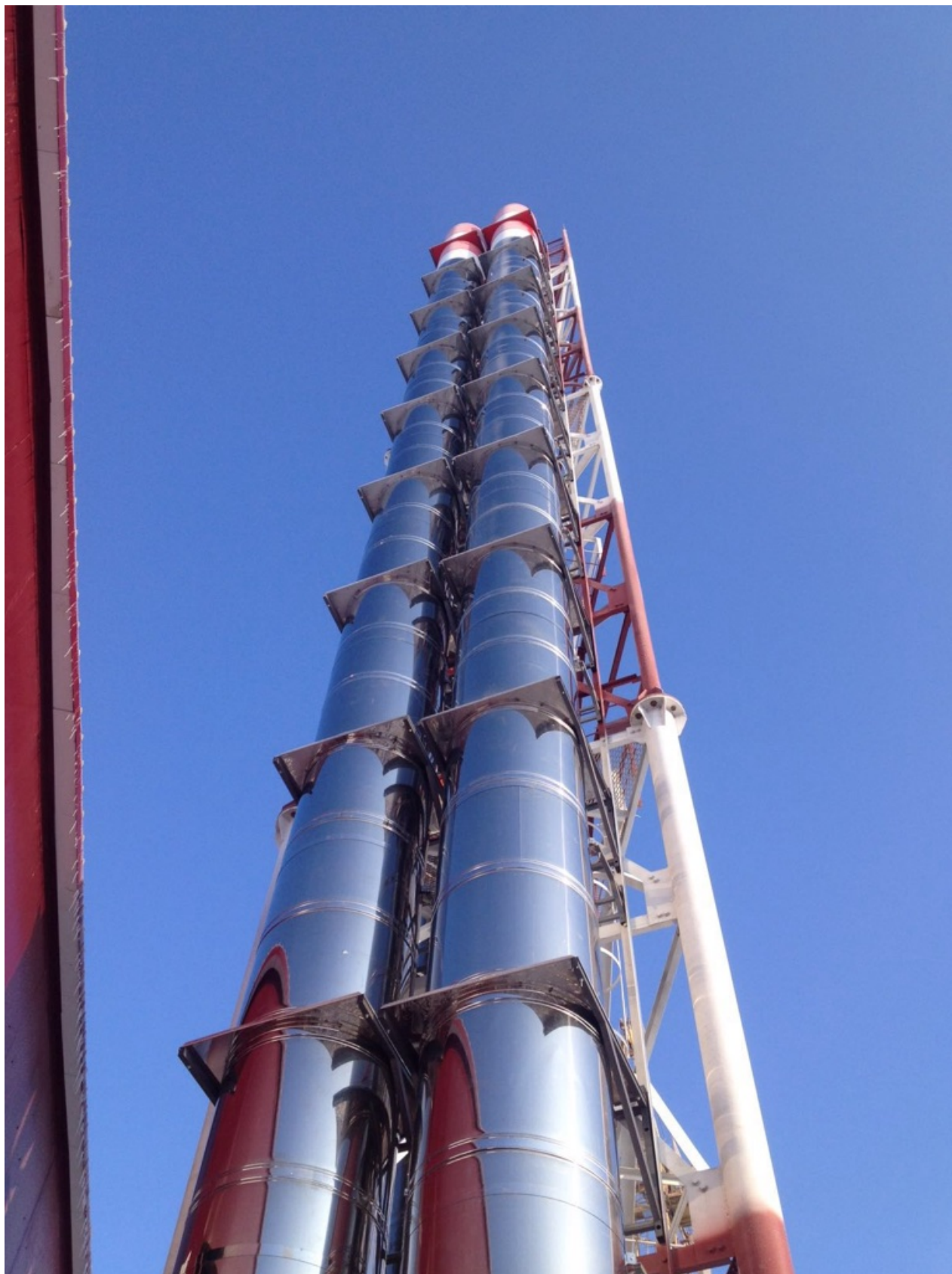
г.Краснодар, котельная 1-й Лиговский проезд ф1000х1100мм, 4шт, Н=32м
